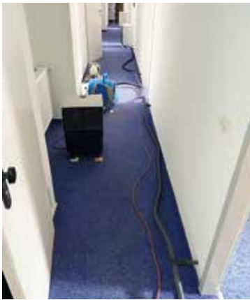
Mehrere Etagen mussten getrocknet und belüftet werden
