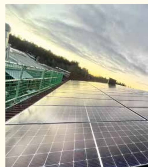
Ein Großteil des Daches der MBS Zentrale in Inning wurde mit Solarpaneelen bestückt
