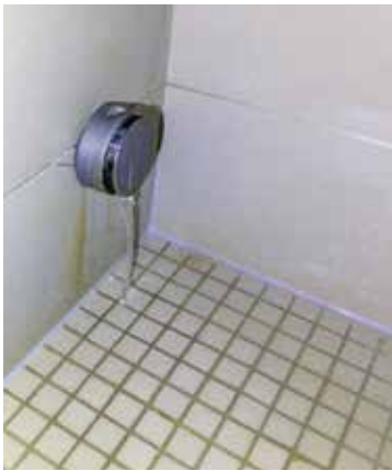
Der geortete Wasserschaden im Wellnessbereich
