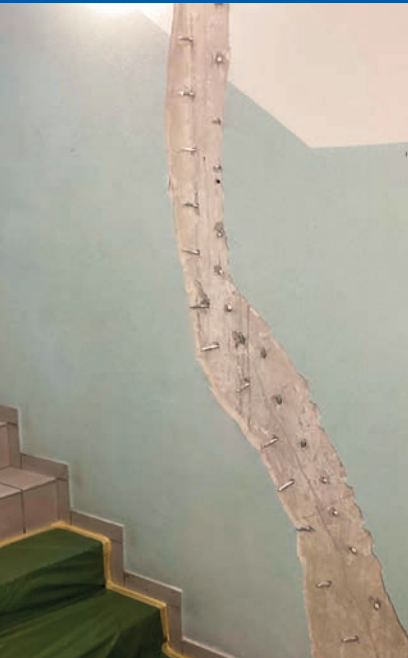
Abdichtung von Wandrissen
