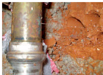
Bild oben: Eine Infrarotkamera macht die Leckstelle ohne weiteren Schaden sichtbar. Bild unten: Eine freigelegte Leckagestelle.
