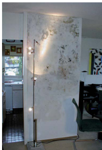
Typische Wasserflecken an der Wand mit ersten Anzeichen von Schimmelbildung.
