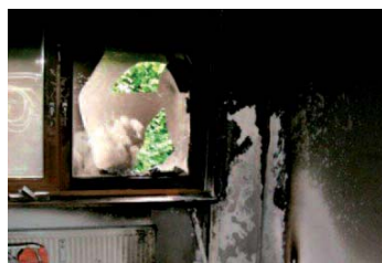
Die Fenstereinheit wurde komplett zerstört.
