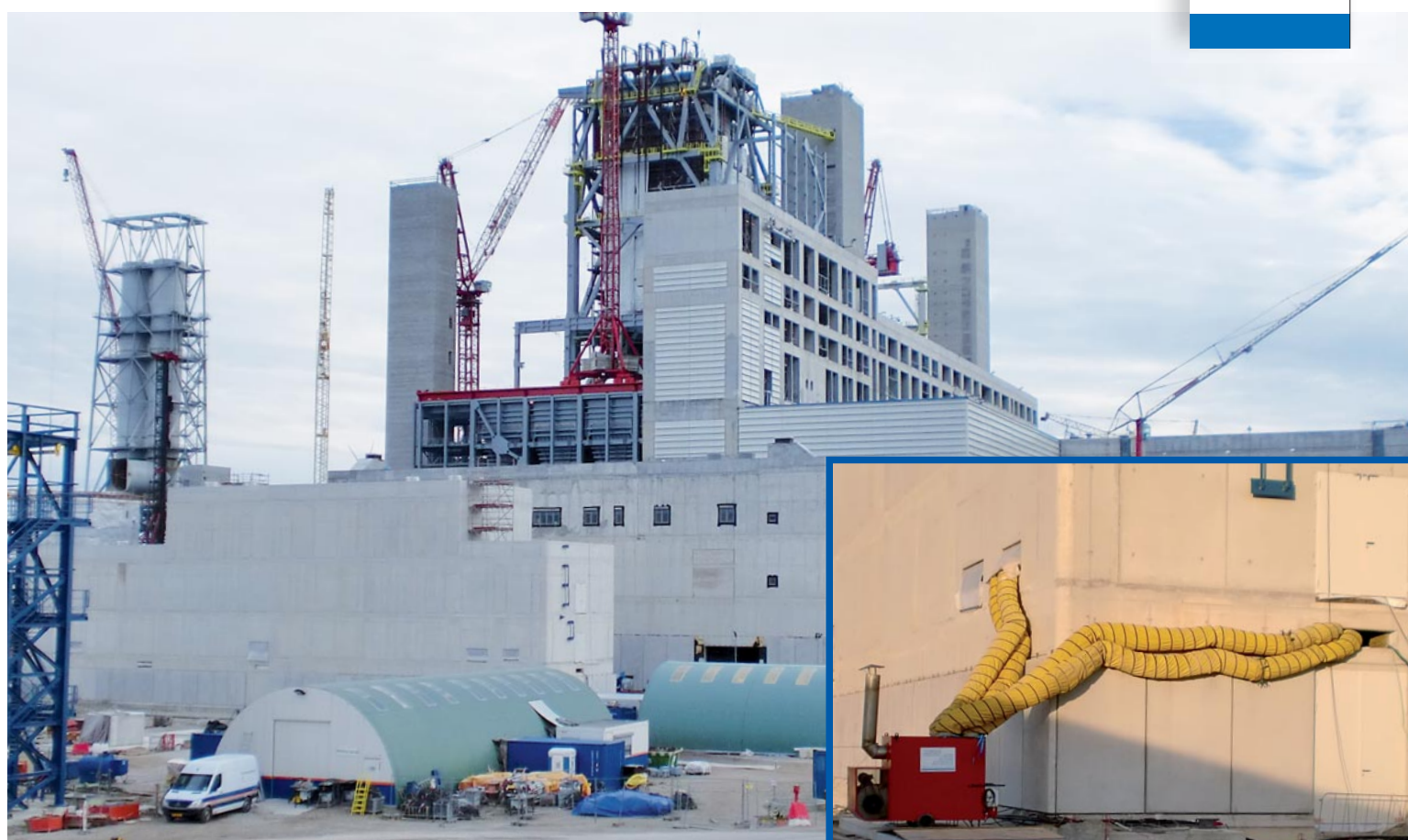
Das von MBS beheizte Braunkohlekraftwerk der RWE.
