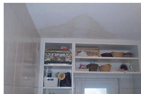
Wasserflecken im Deckenbereich sind deutlich erkennbar.
