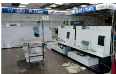
Bild oben: Durch den Brand stark beschädigter Wohnraum. Bild unten: Die durch Löschwasser geschädigten Räume des Ladengeschäftes im Erdgeschoss.
